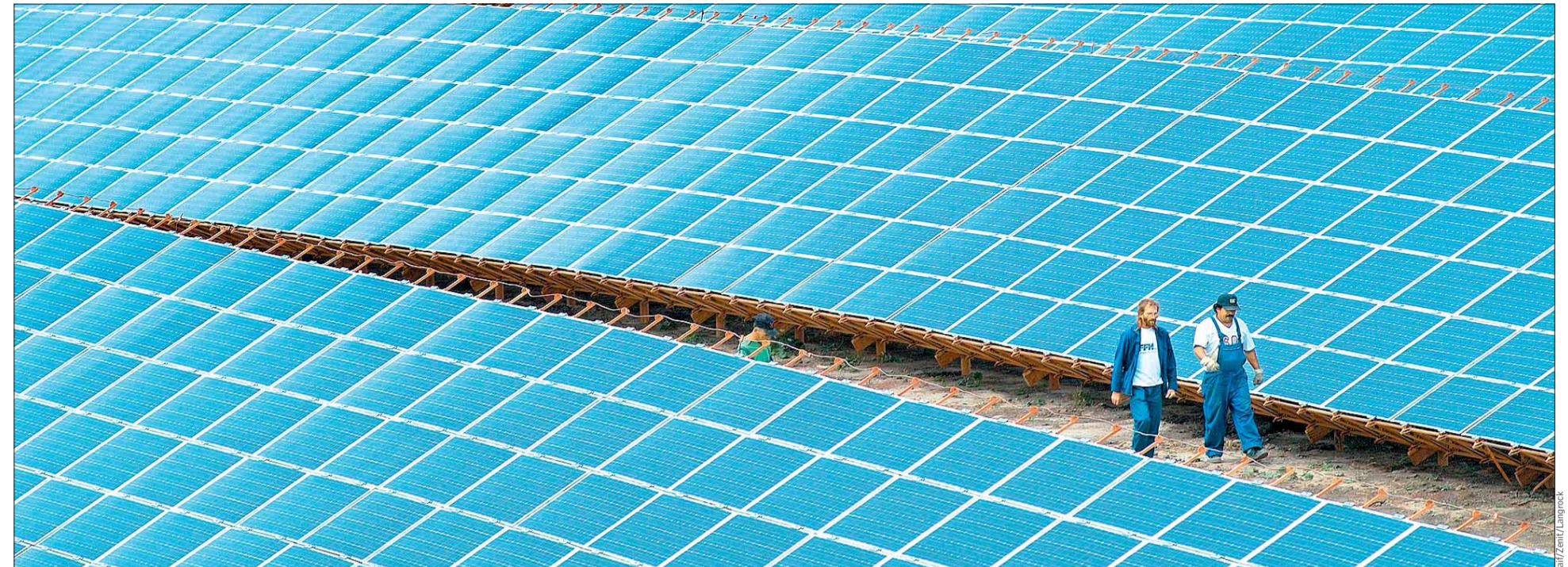
Vom Braunkohletagebau zum weltweit größten Solarstromkraftwerk – das „Leipziger Land“ bringt eine Spitzenleistung von fünf Megawatt und steht auf Pfählen aus einheimischem Holz
